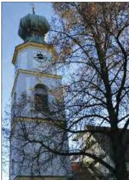
Rechtzeitig zum Festjahr wird derzeit auch die alte Dorfkirche St. Georg renoviert. Der Kirchturm zeigt bereits seinen neuen Glanz. Fotos: Romanus Scholz
